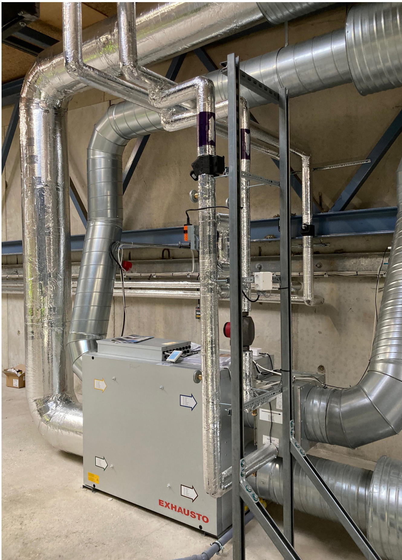
Redux, nyt ventilationsanlæg
