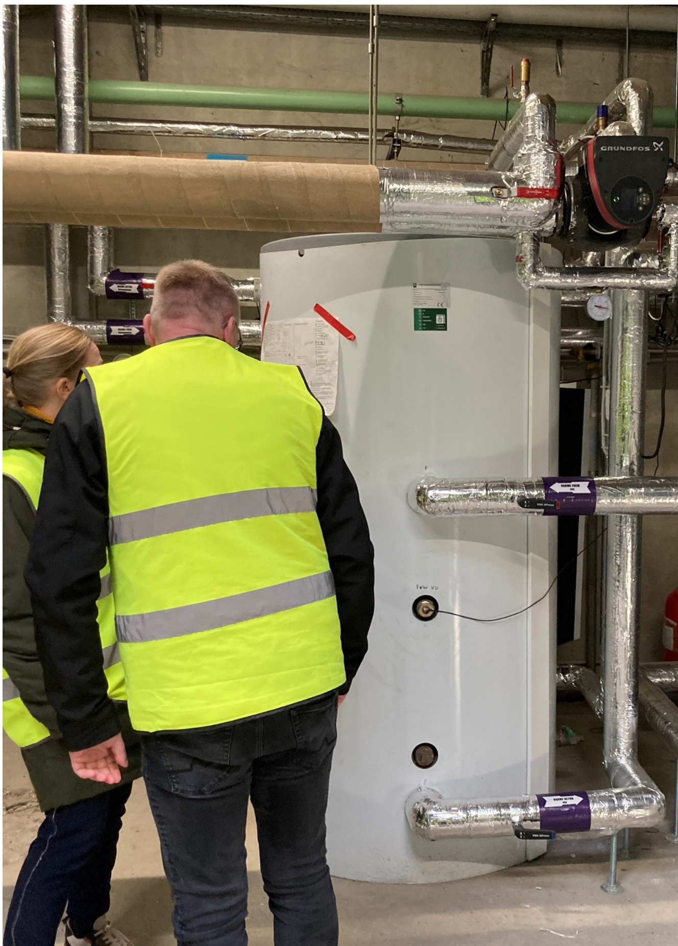
Redux, installationer i forbindelse med opsætning af varmepumper
